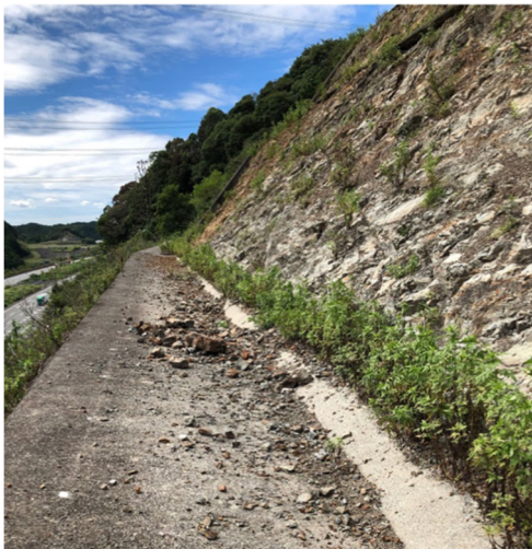
(b) 亀裂が発達した泥岩斜面からの落石状況
