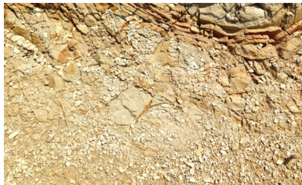
写真-1 リッパで掘削した泥岩の切土法面(神戸市北区)：掘削後、1週間で風化が進み、リッパの爪痕が消えて土砂化している。
