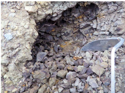
写真-5 掘削から約50年経過した切土法面表面の風化状況 (新生代新第三紀 泥岩優勢砂岩泥岩互層)
