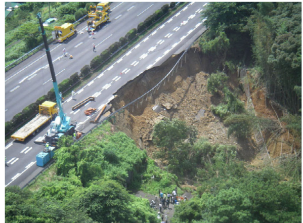
写真-9 牧之原地区の盛土崩落状況 24)
