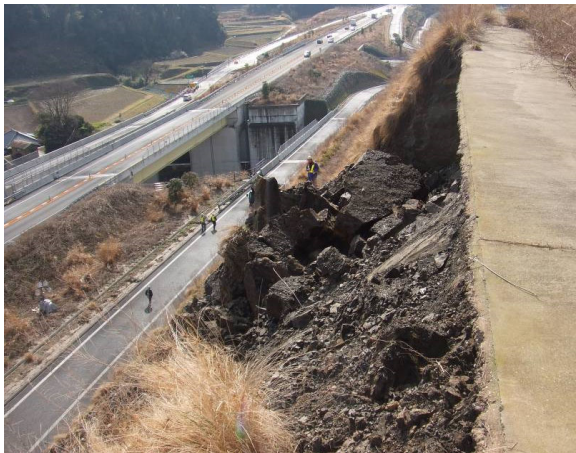
(a) 切土法面の表層崩壊の様子
