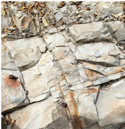
(c) 切土掘削後、数年が経過した泥岩の亀裂発達状況 写真-4 泥岩からなる切土法面の表層崩壊事例
